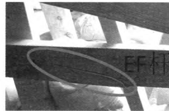
c. 下弦杆断裂
